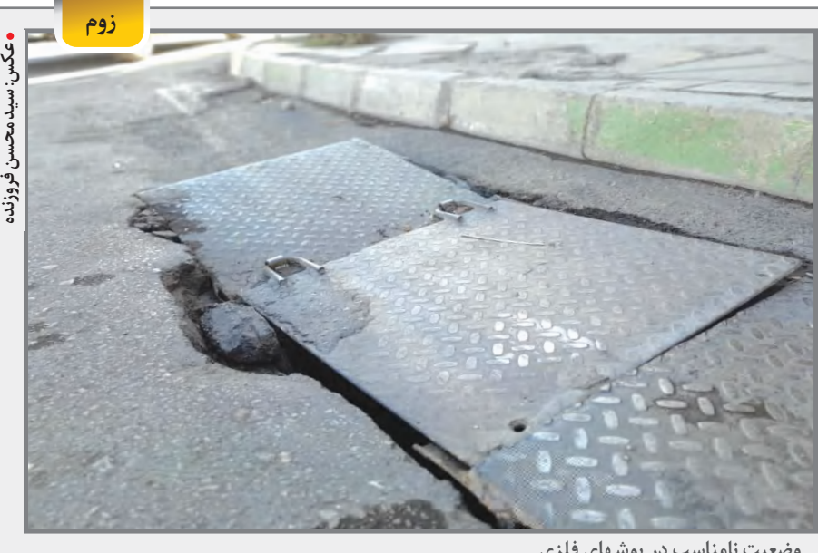
وضعیت نامناسب در پوششهای فلزی ...
