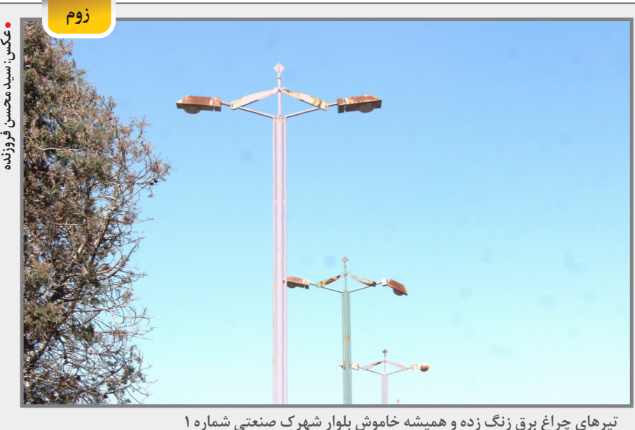
تیرهای چراغ برق زنگ زده و همیشه خاموش بلوار شهرک صنعتی شماره ۱
